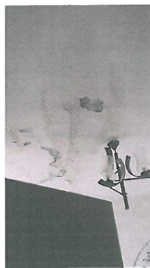
Infiltrazioni diffuse dal solaio di sottotetto
