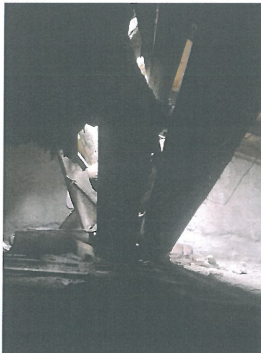
Squarcio nel tetto di copertura
